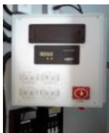
12 Volt Converter Switches
