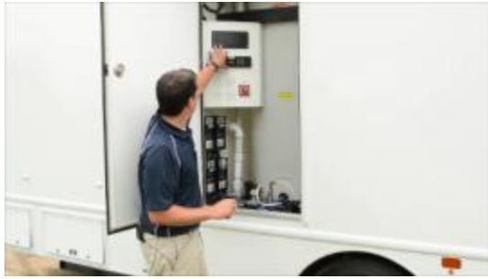
12 Volt Panel - Converter
