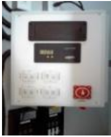
12 Volt Converter Switches
