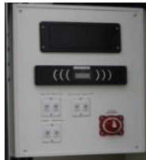
12 Volt Converter Panel Switches
