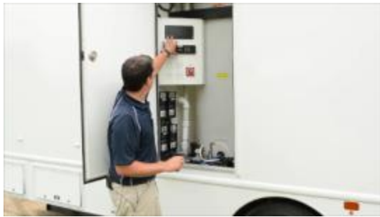
12 Volt Panel - Converter
