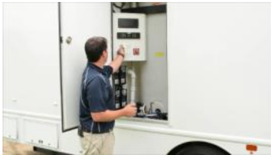
12 Volt Switches in Unit
