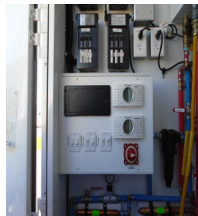
12 Volt Converter Panel Switches
