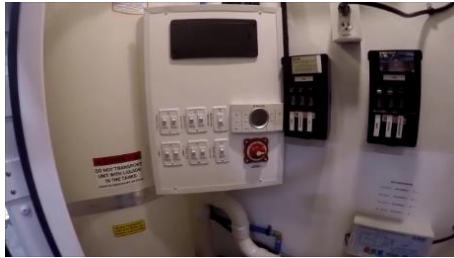
12 Volt Switches in Unit
